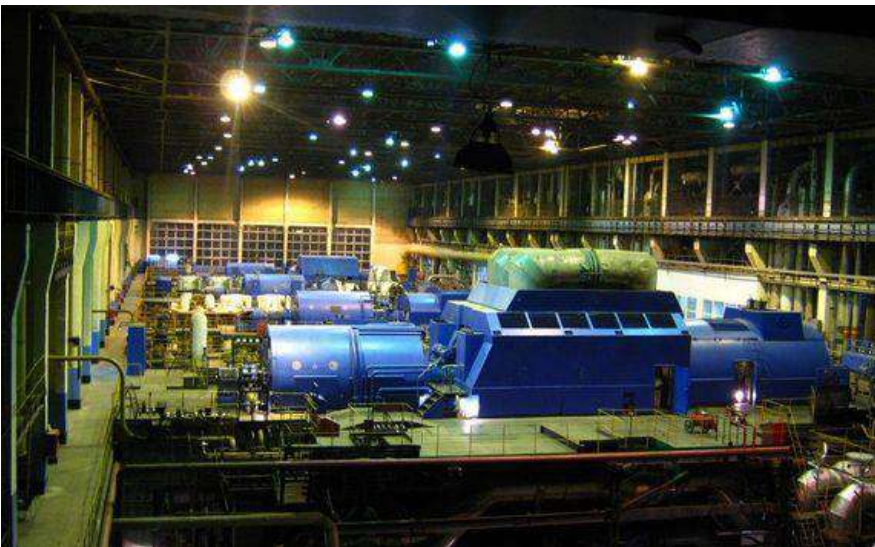
ТОВ «Кременчуцька ТЕЦ», турбінне відділення котлотурбінного цеху (турбогенератор Т-100-130 № 4, на задньому плані турбогенератори Р- 50-130 № 3 і ПТ-50-130 № 1, 2; відповідно потужність кожної 105, и по 50 МВт).
