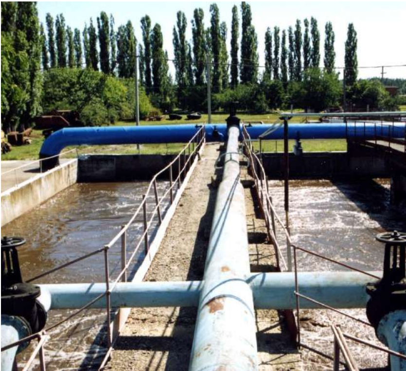
Супрунівські очисні споруди ОП «Полтававодоканал»
